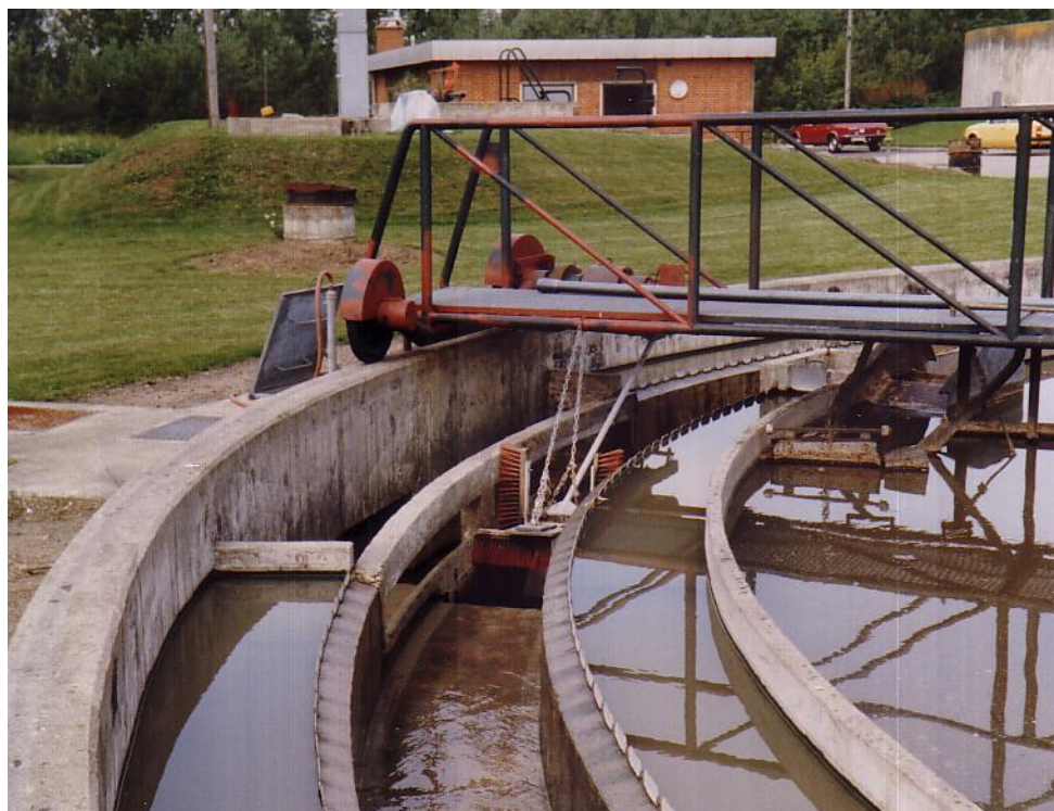
Forklaringstank. Afløbsrende renses med 3-fløjet kosteaggregat monteret på broen
