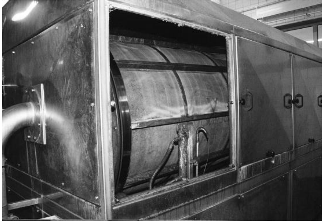
Tromleafvander til forafvanding af slam. Egå renselanlæg
