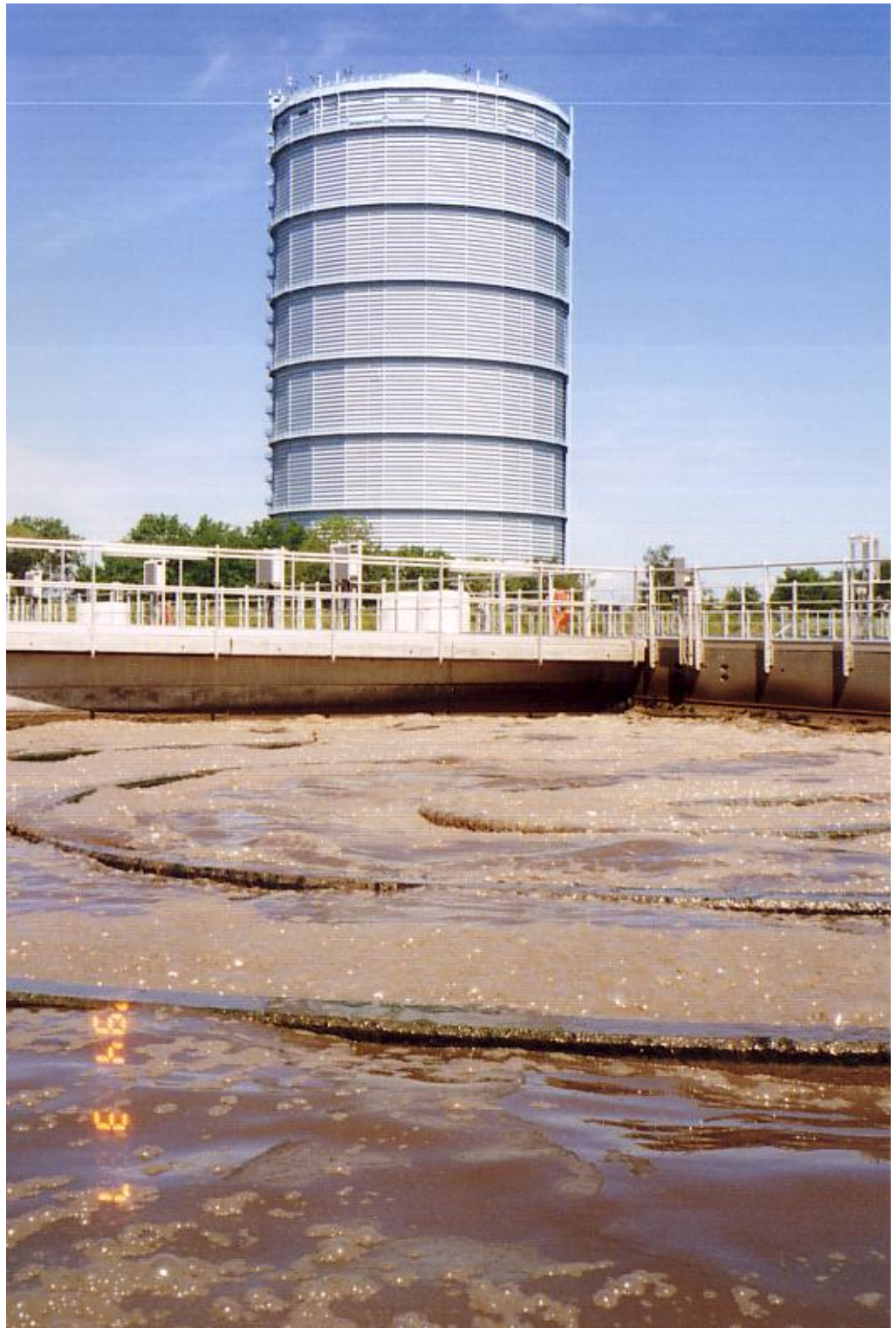
Nitrifikations- og denitrifikationstank, Renseanlæg Damhusåen, København
