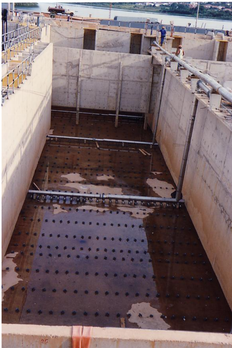
Bunddiffusorer i aktiv-slamtank. Rørene fører trykluft ind i diffusorerne, hvorfra der stiger små luftbobler op gennem det aktive slam. Jo flere bobler, desto højere iltindhold i tanken, hvilket er godt for nitrifikationen
